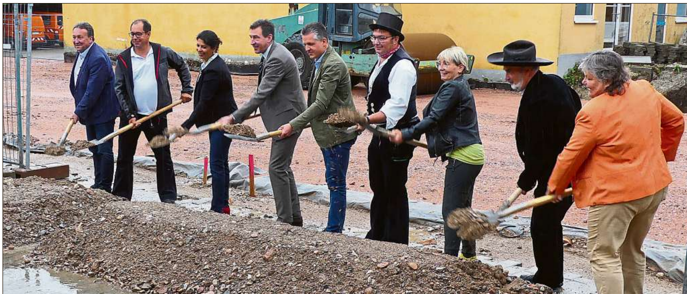
Spatenstich für die Abbundhalle (von links): Ingo Hermann, Martin Georg, Derya Türk-Nachbaur, OB Erik Pauly, Thorsten Frei, Christian Denz, Tanja Raufer, Gerhard Heinzmann und Martina Braun. Foto: Matthias Kunkel, Bildungsakademie der Bauwirtschaft BW
