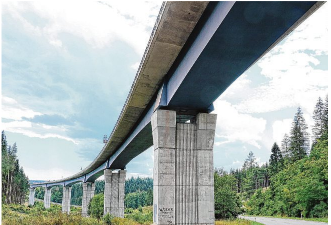
Die Gauchachtalbrücke führt zum Dögginger Tunnel. Um den Bau eines Brückenwillings tobt derzeit ein erbitterter Kampf. Ein gerichtliches Urteil hat im August für einen Baustopp gesorgt. BILD: JENS WURSTHORN
