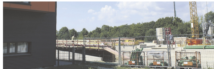
Die Firma Stumpp ist mit den Betonarbeiten am Kita-Erweiterungsbau „Stadtkäfer II“ in Bad Dürkheim fast fertig. Foto: Marcella Danner
